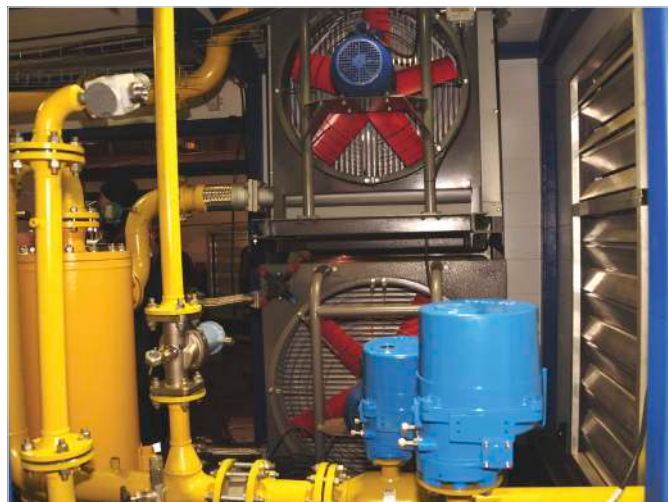
Рис. 2 — Газовая станция БКК, вид изнутри
