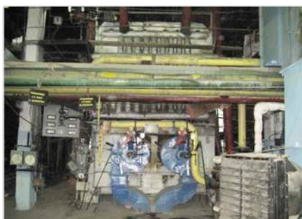
Рис. 1 — Паровой котел ДКВР-20 в 2009 году
