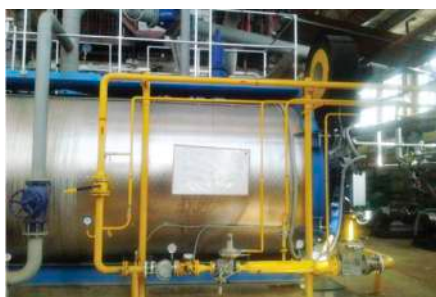
Рис. 2 — Водогрейный котел Buderus
