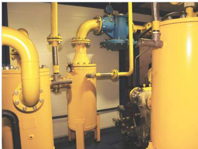
Рис. 1 — Газовая станция БКК, вид изнутри
